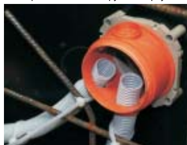
Смонтированные гибкие трубки в корпусе KBT.
